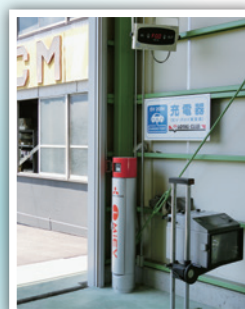
▲設置した充電設備
